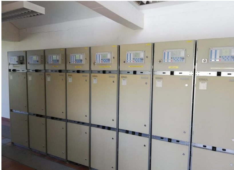
Slika 3. Rasklopno postrojenje R-Valpovo 3 10 kV
